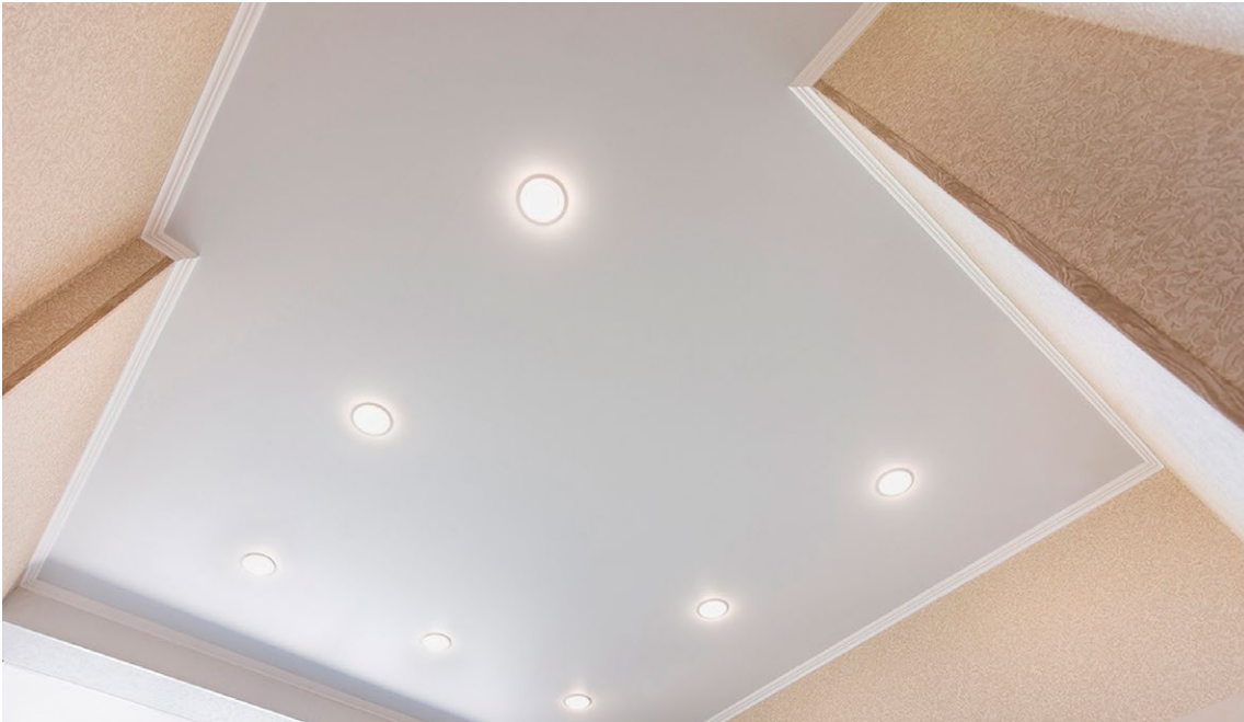
Sanierungsprojekt mit integrierter Beleuchtung: B+M Heiz- und Kühldecke (Foto: B+M)
