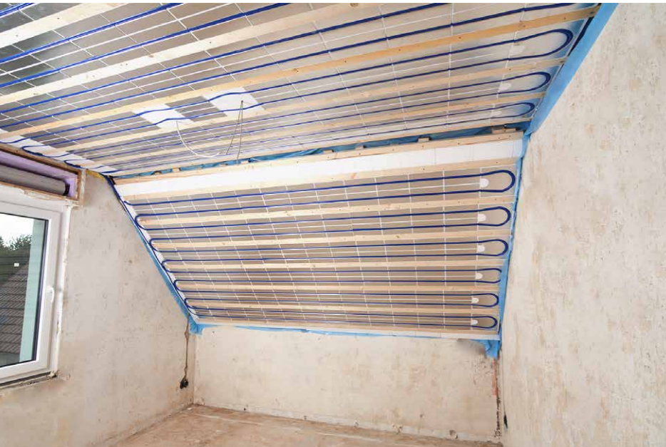
Ausstattung eines bestehenden Obergeschosses mit einer Deckenkühlung/-heizung. Die Heizelemente wurden dabei zwischen der Konterlattung fixiert und anschließend mit Gipskartonplatten beplankt (Foto: BVF)
